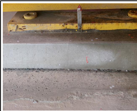
위 치 교량받침 A1-SH1 현 황 무수축몰탈 균열( Cw < 0.3\text{mm} )
