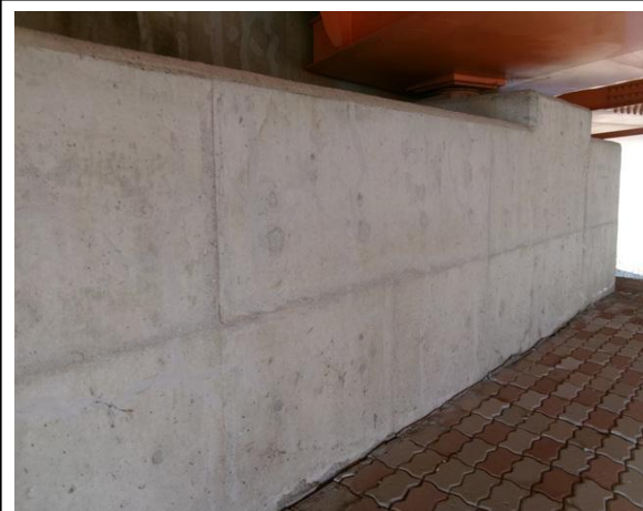
위 치 교대 영천방향 A1 현 황 보수부 망상균열(A=8.0m×1.5m)
