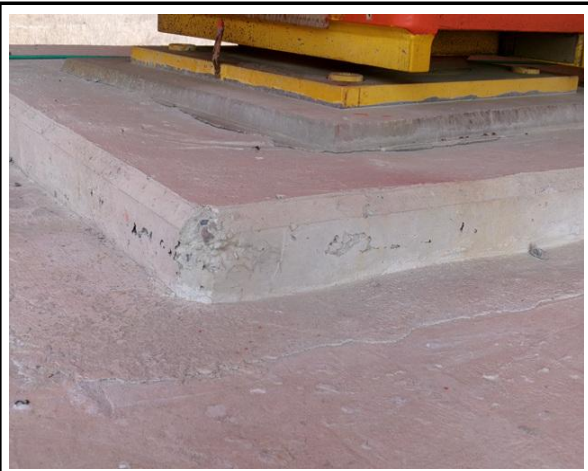
위 치 교량받침 P2-SH3 현 황 받침콘크리트 재료분리( A = 0.3\text{m} \times 0.2\text{m} )
