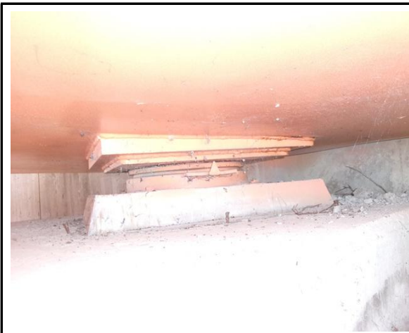
위 치 교량받침 영천방향 A1-SH1 현 황 이동량 표시계 탈락 1EA
