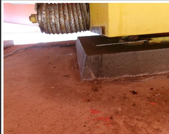
위 치 교량받침 P4-SH6 현 황 무수축몰탈 박리( A = 0.2\text{m} \times 0.2\text{m} )
