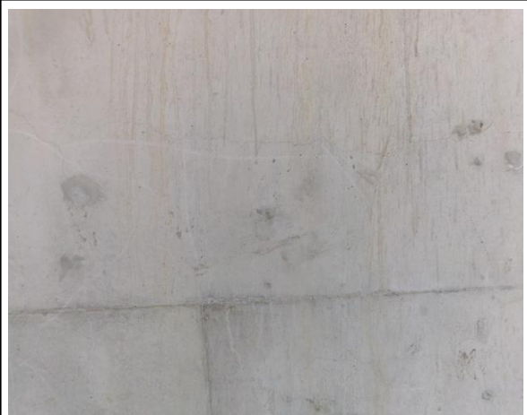
위 치 교대 A1 현 황 망상균열( A = 2.0\text{m} \times 2.0\text{m} )
